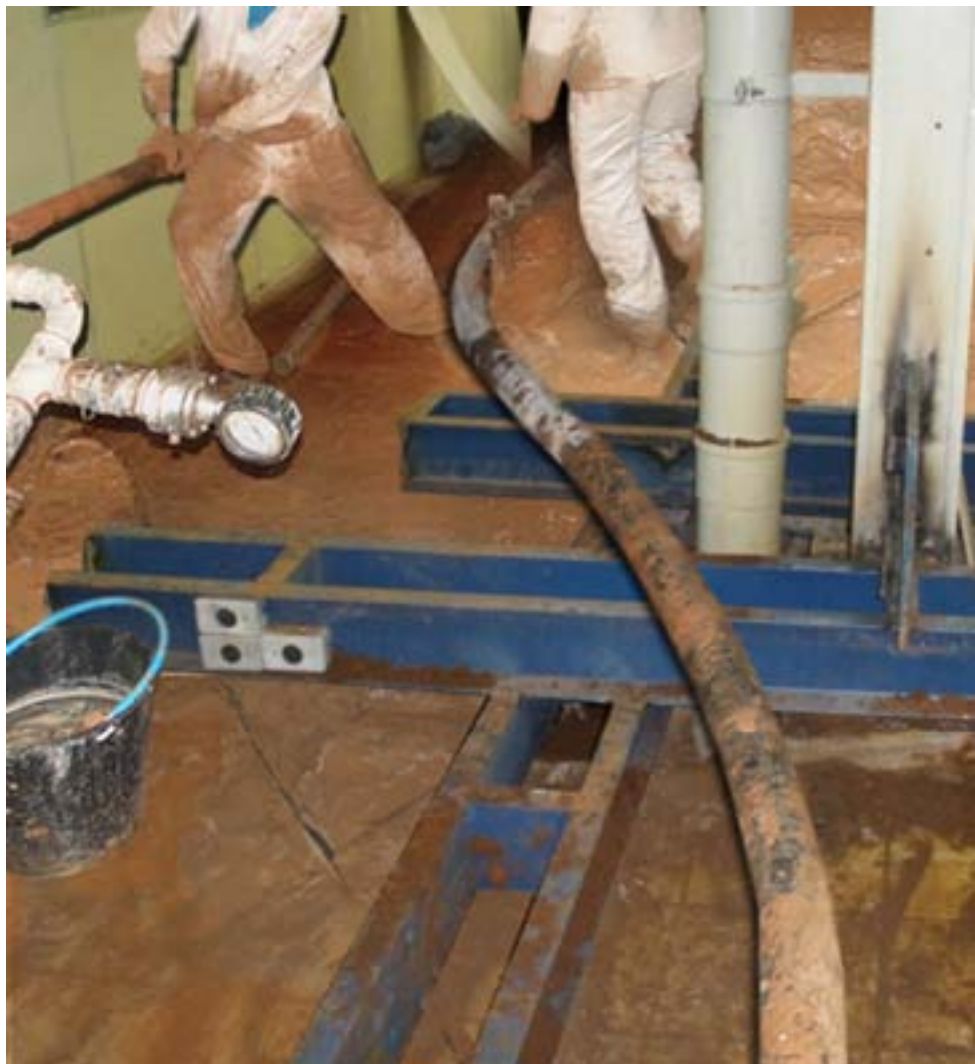
As dificuldades de acesso ao solo sob a laje radier.
