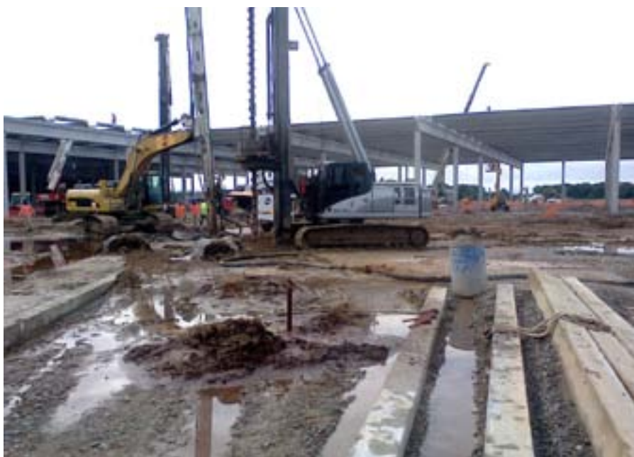
Obras de enrijecimento do solo de fundação, devido a presença de depósitos de solo mole com 20m de profundidade
