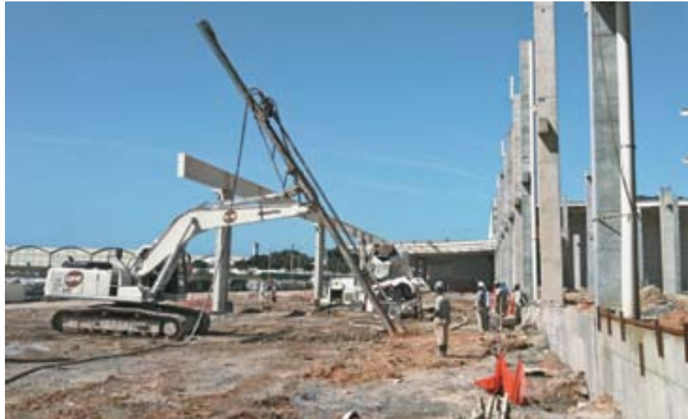
Serviços de enrijecimento do solo e aumento da capacidade de carga com CPR Grouting na obra de Condomínio Logístico em Cabo de Santo Agostinho.
