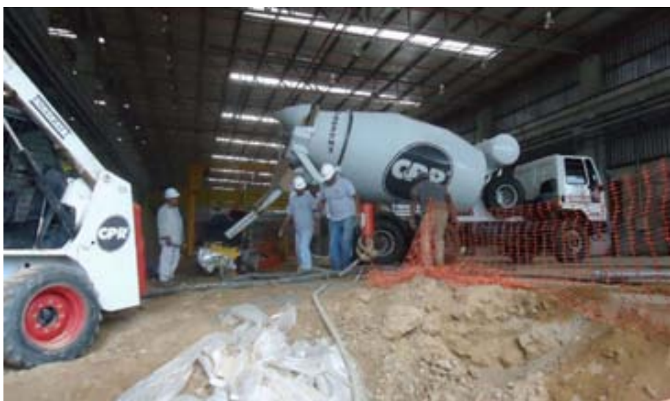
Os serviços de adequação do solo para atender as necessidades de projeto.
