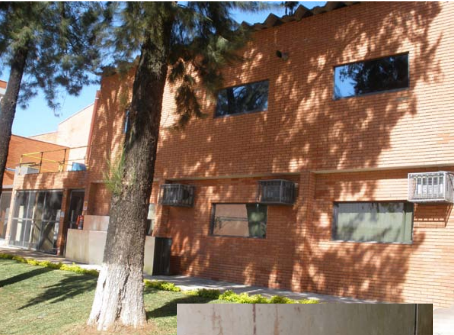
Parte do parque gráfico onde situavam-se processo de recalque no pavimento industrial.
