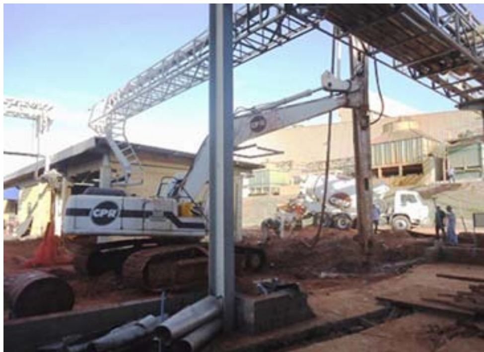
A severidade do problema de afundamentos dos pavimentos, que apresentava velocidades de recalque preocupantes, exigiu sua intervenção rápida na adequação do solo.
